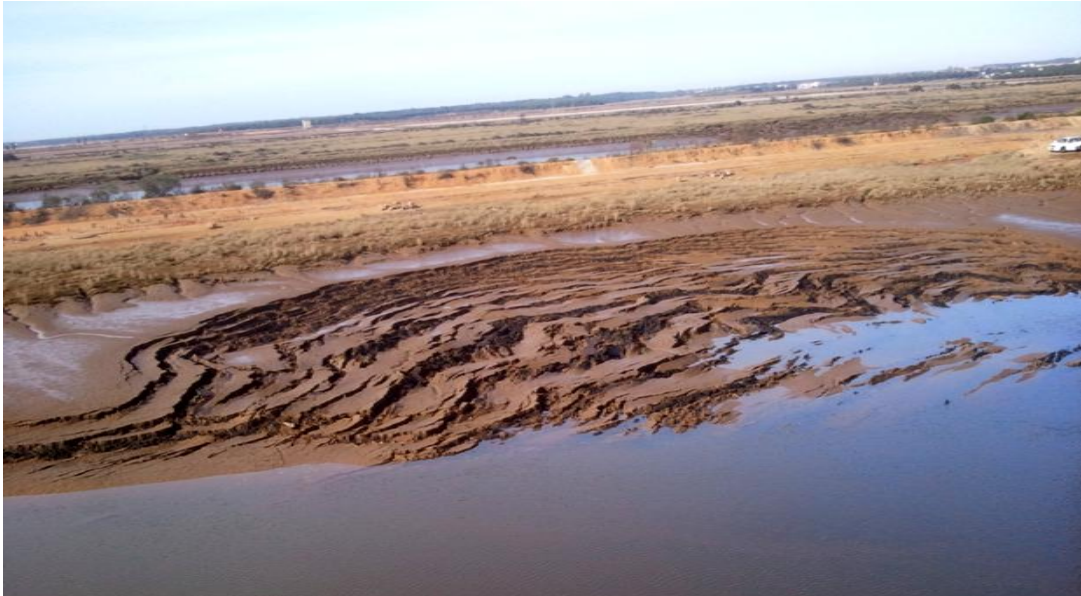
Figura 28. Deslizamientos generados en la orilla debidos al descalce de la misma por erosión en el margen del canal durante una avenida del Odiel.
